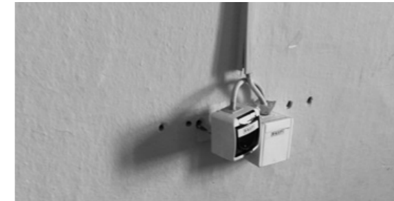
Poškodovana vtičnica v ZPKZ Ig
